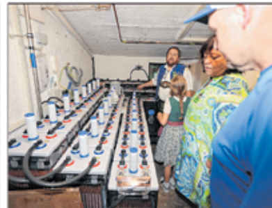
Bei einer Hausführung gab es Informationen über die neue Technik in der Wimbachgrieshütte.
